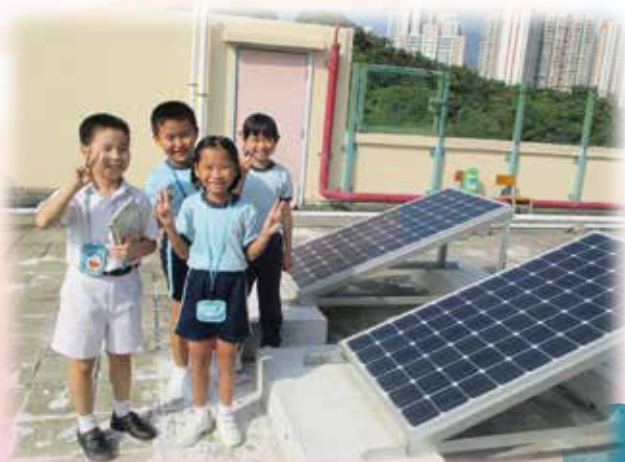
研習校舍太陽能發電設備
